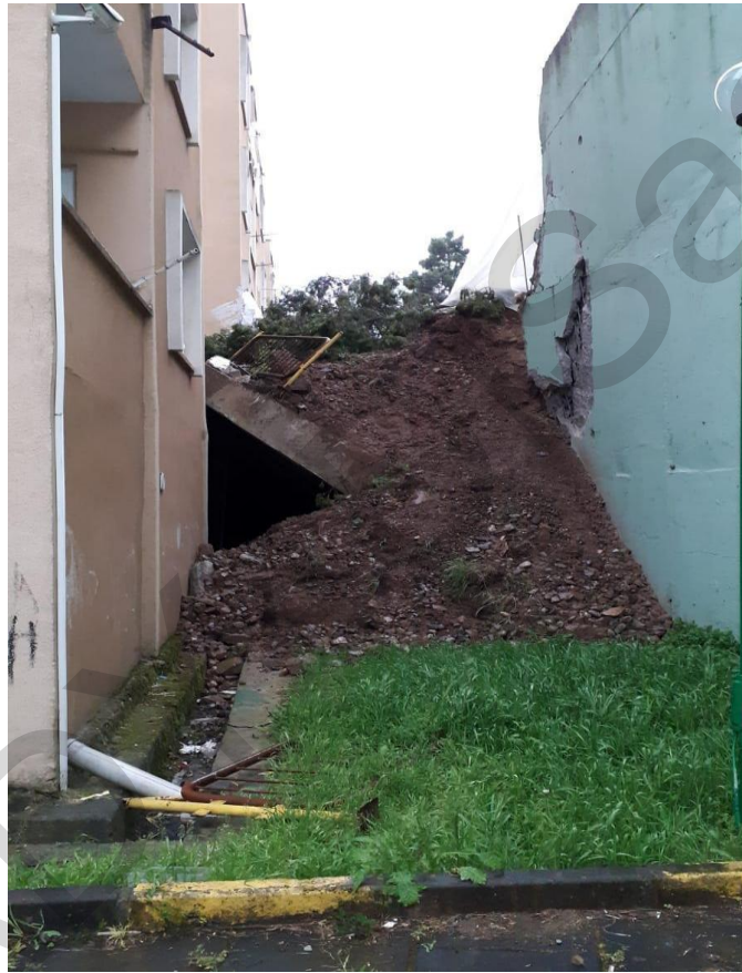
Σχήμα 3.18. Κατεστραμμένος τοίχος αντιστήριξης και μετακίνηση εδάφους
