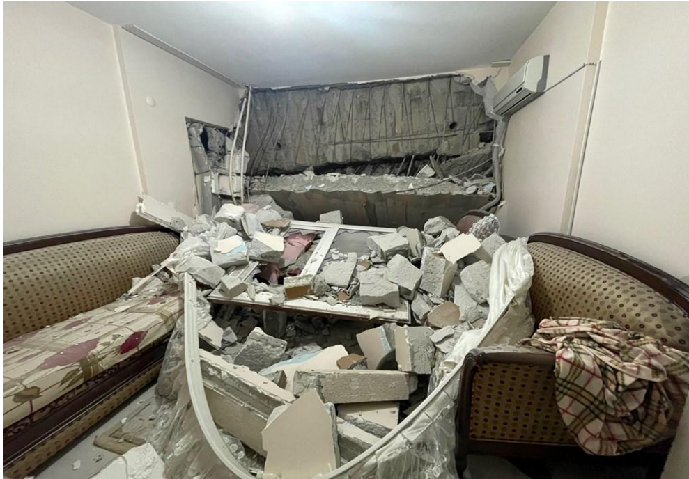
Σχήμα 3.19. Τοίχος δωματίου μετά από κατάρρευση εξαιτίας κατολίσθησης
